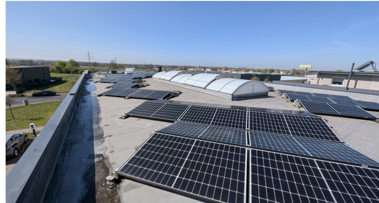
Photovoltaikanlage zur nachhaltigen Energieversorgung direkt auf dem Betriebsdach.
