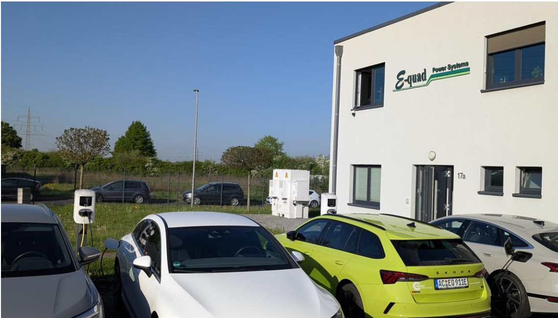
Betriebsgebäude mit Ladeinfrastruktur und Batteriespeicher für die E-Fahrzeugflotte.
