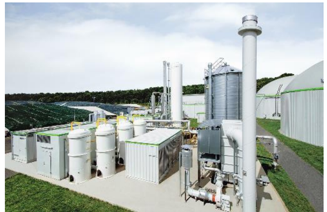
Abbildung 2: Biologische PtG-Anlage. Bild: Viessmann
